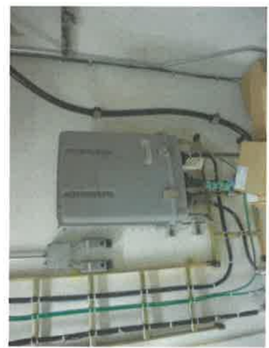
3 EXISTING RAYCAP JUNCTION BOX IN SHELTER SCALE: N.T.S.
