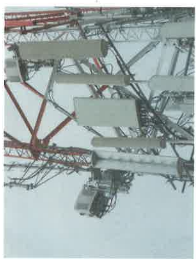
2 PHOTO OF ANTENNA LEVEL SCALE: N.T.S.
